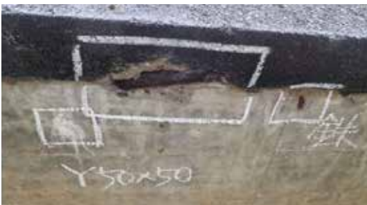
左岸側(信末側) 橋脚付近の床版における鉄筋露出状況
