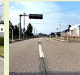
水の課題による消雪装置未設置路線県道池尻福野線等
